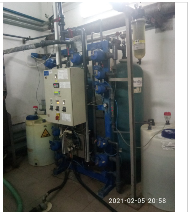
Рис.5. Гідравлічна частина установки водопідготовки з катіонними фільтрами.
