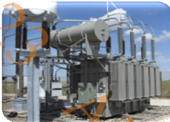
Рис. 2.9 Загальний вид трансформатора
